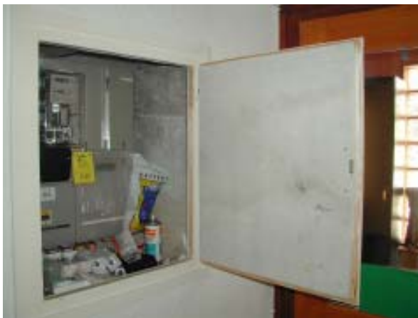
Caisse de sécurité avec plaque de protection antifeu contenant de l'amiante à l'intérieur de la porte, photo: JMF/SLE, IST
