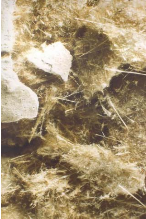
Flocage composé de laine minérale et d'amiante, photo: SA
