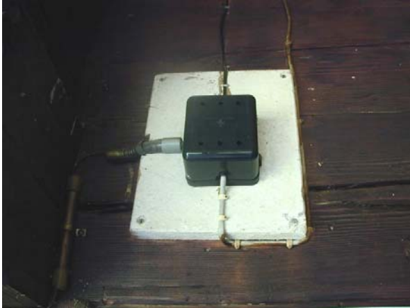
Carton d'amiante derrière un boîtier téléphonique, photo: JMF, IST
