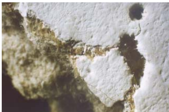
Plaque de faux plafond composée de laine minérale et d'amiante, photo: SA
